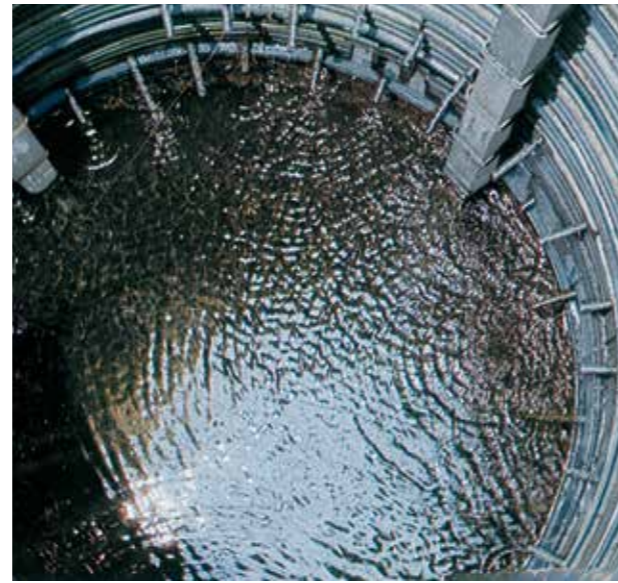
集水井 (集水管)
