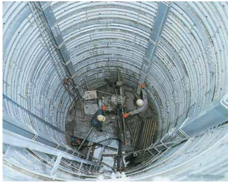
集水井 (集水ボーリング)
